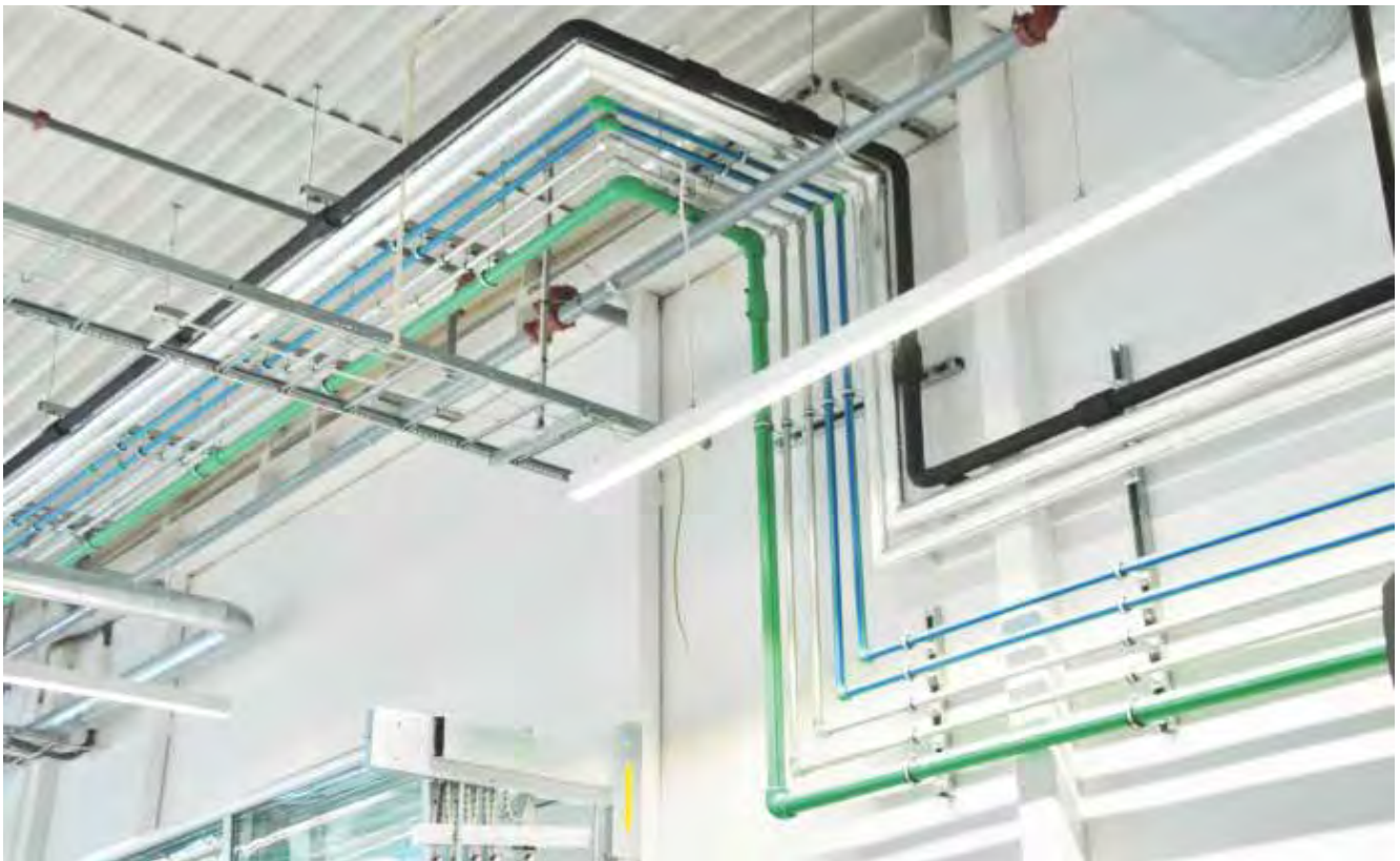
Aquatherm green pipe- og blue pipe rør.
